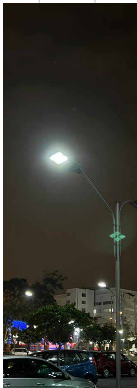
LUMINARIAS FOTO VOLTAICAS
