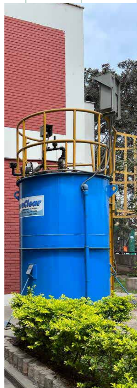
RECICLAJE DE AGUAS NEGRAS
